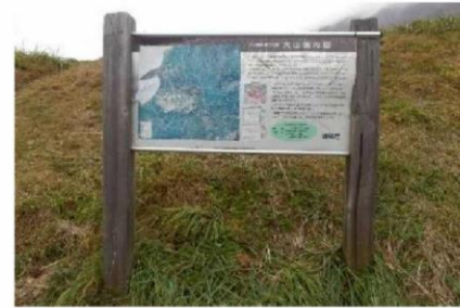
高山地の標識板面の紫外線劣化
