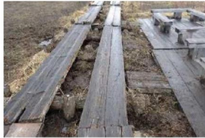
湿地の湿度による劣化
