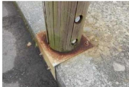
沿岸での塩害による錆の発生
