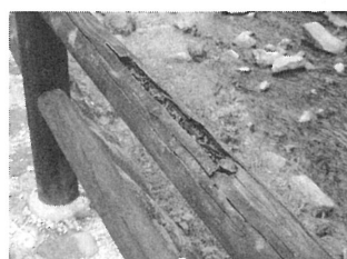
写真2 手摺材に発生した腐朽(保存処理材)
