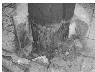
写真1 柱下部の根巻きコンクリート内の腐朽
