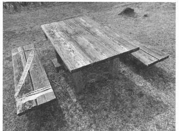
写真2 老朽化により使用禁止になっている野外卓
