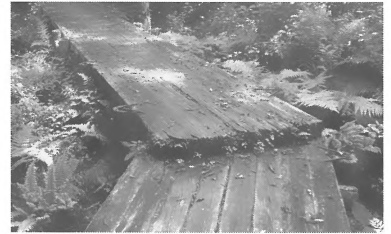
経年劣化した木道
